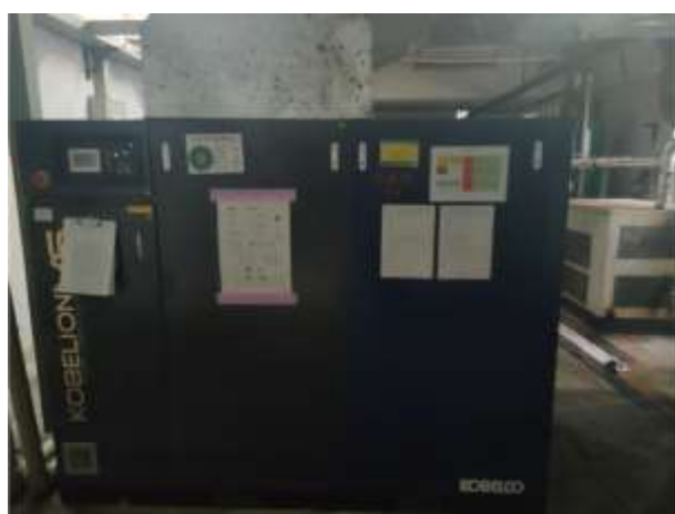
2 台 75kW 永磁電機及變頻的空氣壓縮機
