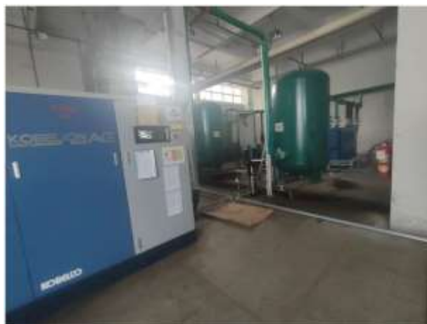
1 台 160kW 永磁電機及變頻的空氣壓縮機
